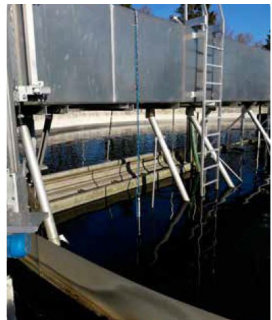
Abb. 1-2: Installation des Sensors NiCaVis® 705 IQ im Nachklärbecken der Kläranlage in Peißenberg
