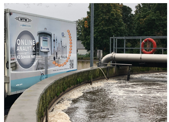
Abbildung 2, 3: Unser Außendienstmitarbeiter Marcus Nickel und sein Messanhänger auf der Kläranlage Bückeberg
