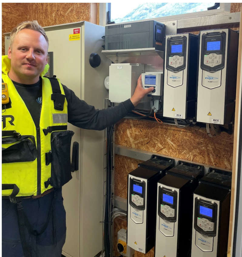
WTW kontroller med skjerm sammen med frekvensomformere for Flygt pumpene gir en sikker tilførsel av lusefritt og friskt vann inn i merdene.
