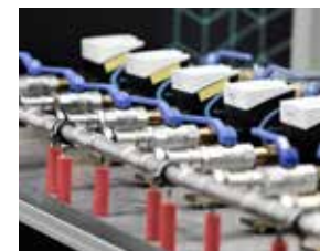
iPerl-Zähler im Einsatz
